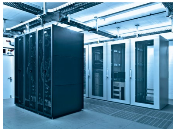
Серверные и уличные шкафы
